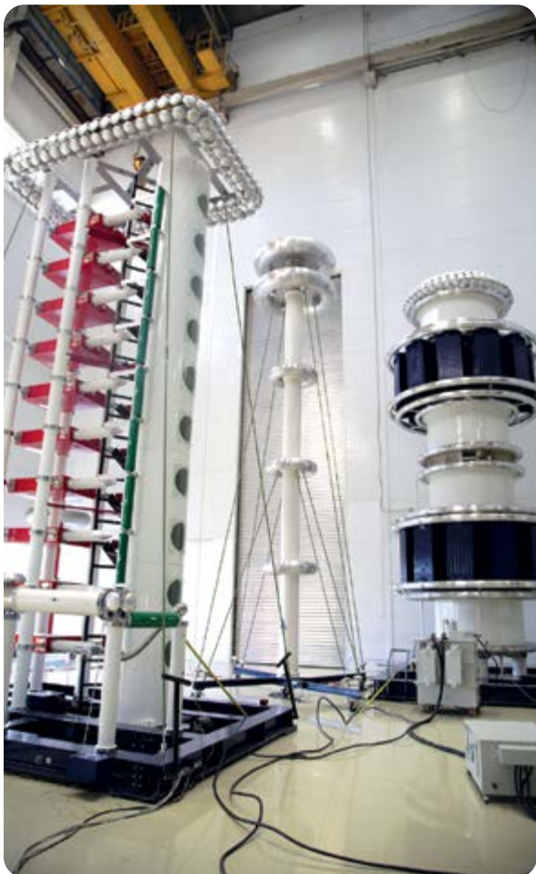
Центр испытаний высоковольтной кабельной арматуры
