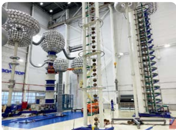
Испытательная станция 220–1150 кВ
