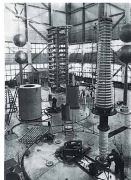
➤ Высоковольтная лаборатория 500 кВ при специальном конструкторском бюро, введенная в строй в первой половине 1970-х годов
