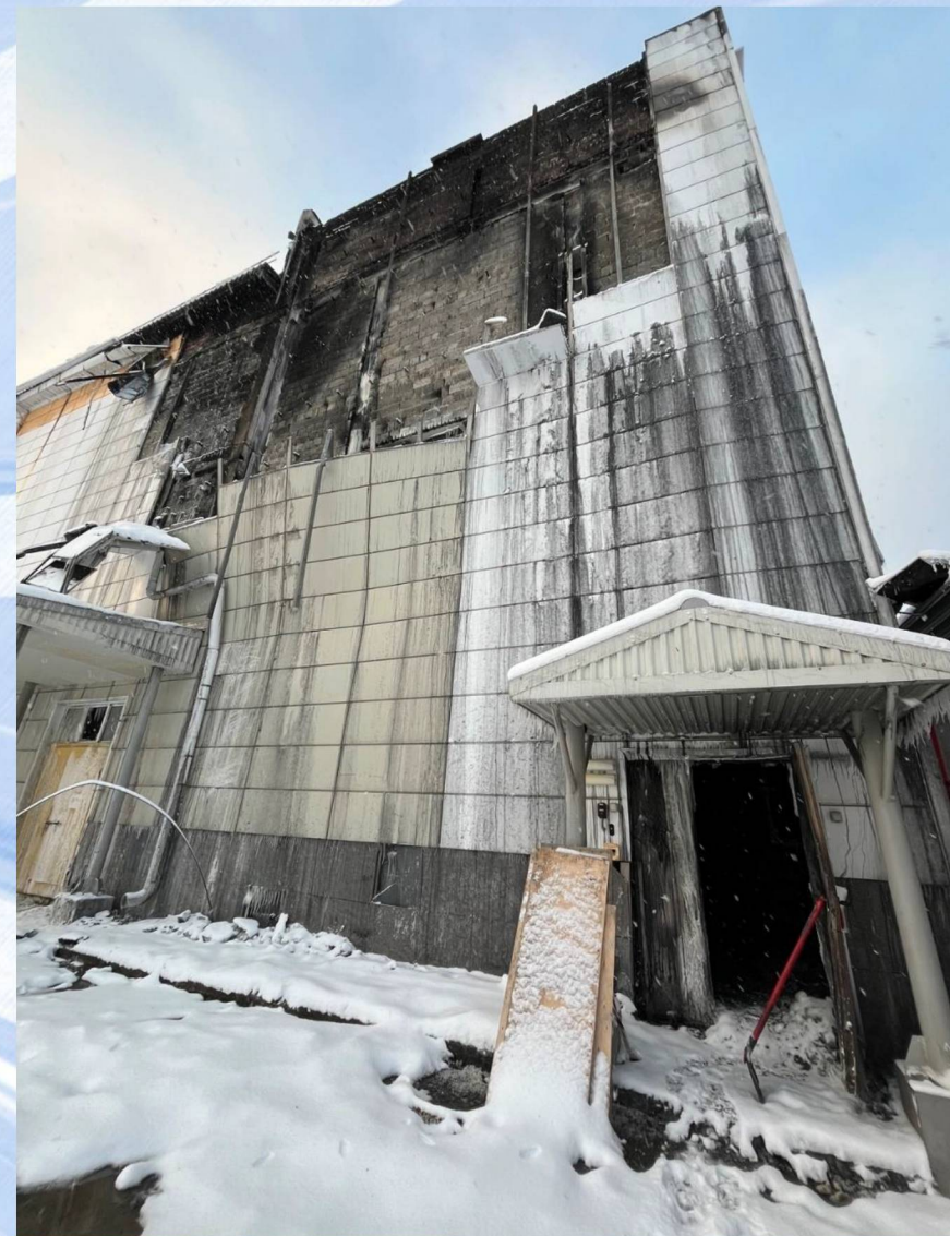
Последствия аварии на ПС Бескудниково
