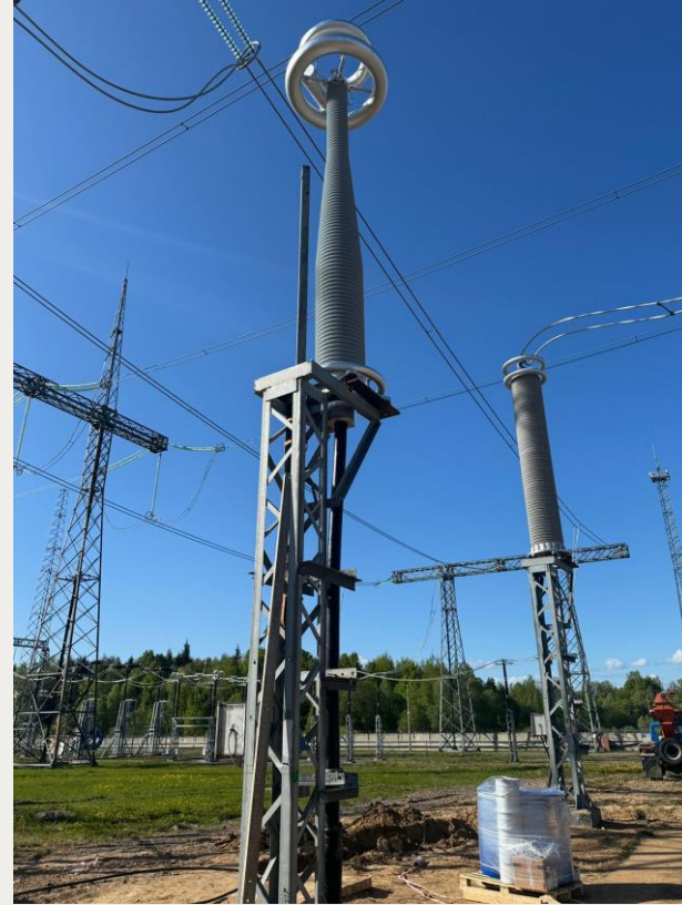
ПС 500 кВ Калужская
