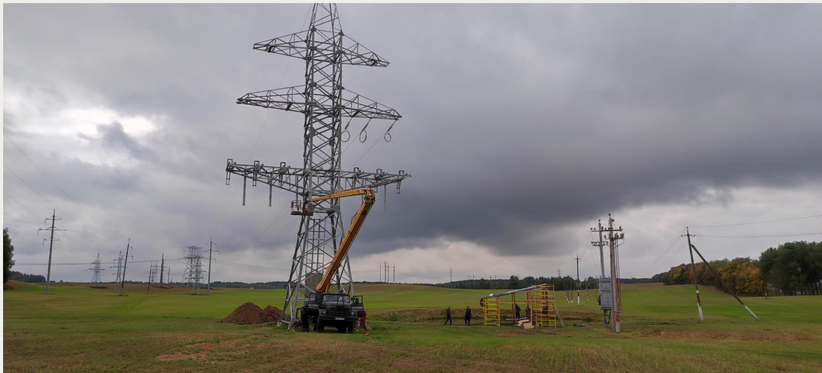
ПС 110 кВ «Острошицкий городок», г. Минск
