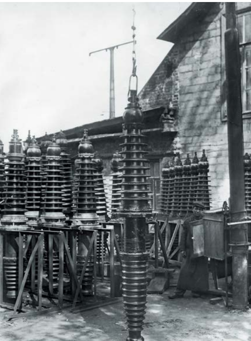
Вводы 110 кВ с маслобарьерной изоляцией. 1930-е годы
