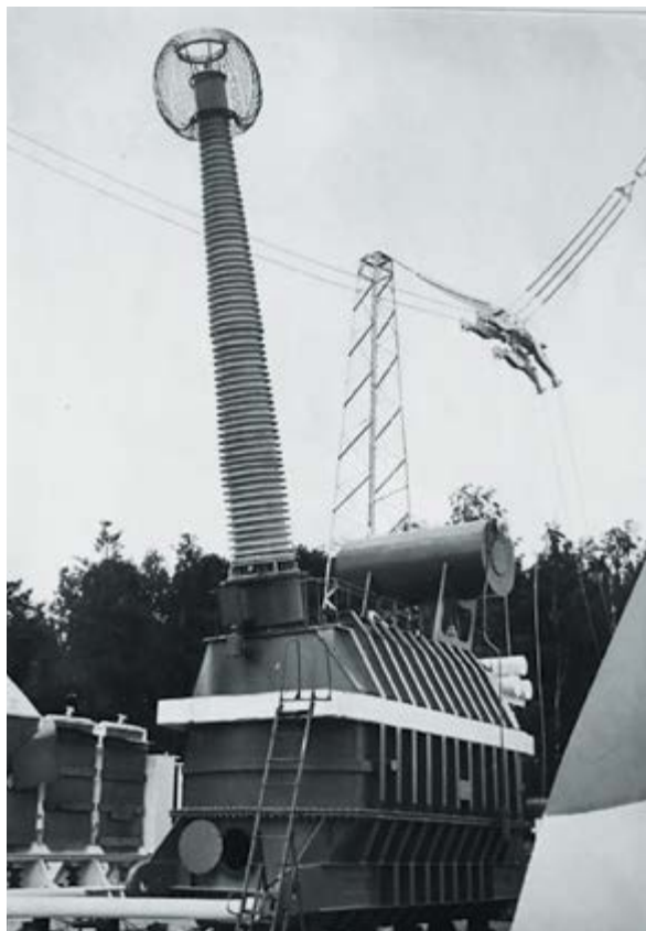
Ввод 1150 кВ на шунтирующем реакторе. 1980-е годы
