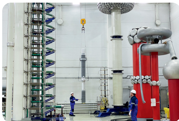
Рис. 23. Электрические испытания ввода 220 кВ
