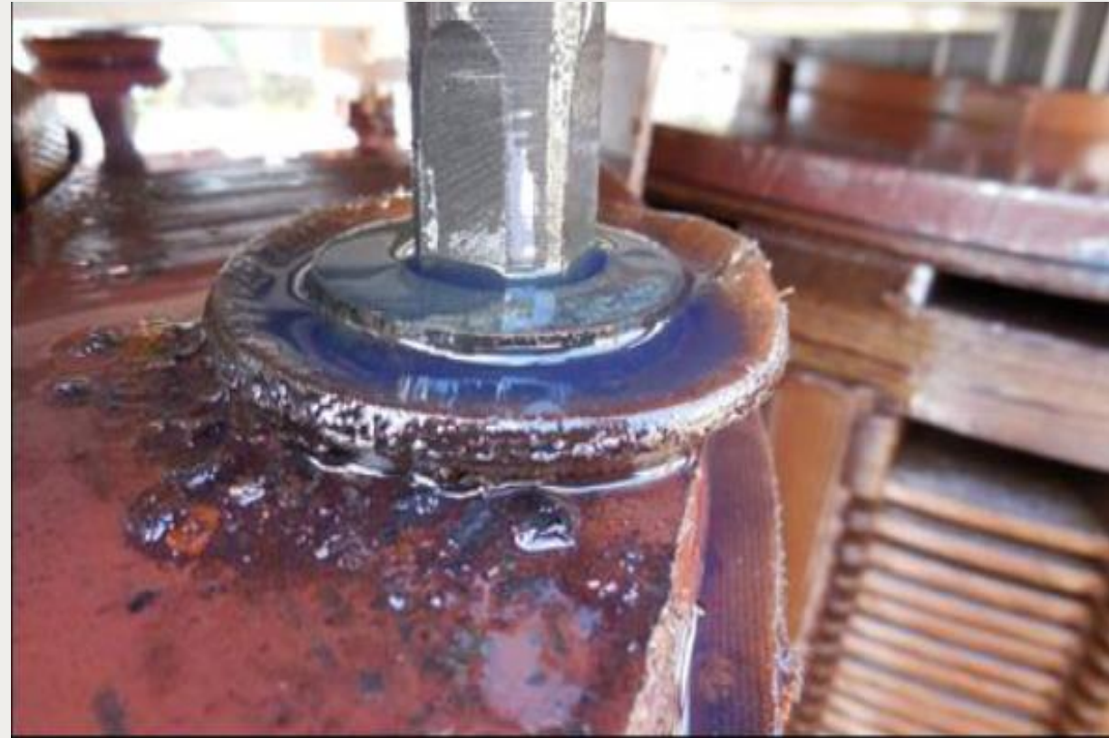
Рис. 1. Дефект трансформатора ТМ-1000/35, обнаруженный при его вскрытии.
