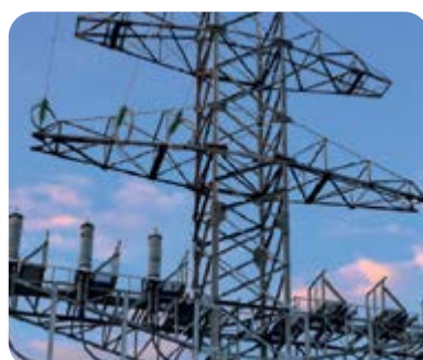
Муфты ИКМ-126 на кабельной линии электросетевой подстанции
