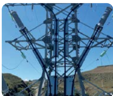
Муфты ИКМ-126 на кабельной линии гидроэлектростанции
