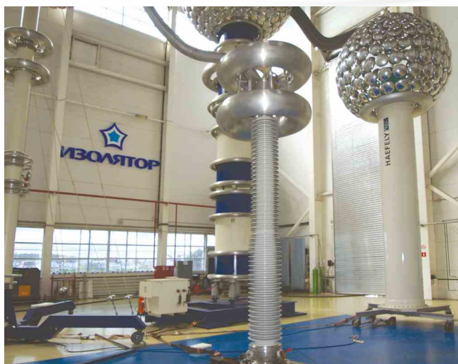
Рис.24 Электрические испытания ввода 550 кВ с RIN-изоляцией в испытательном центре «Изолятор»
