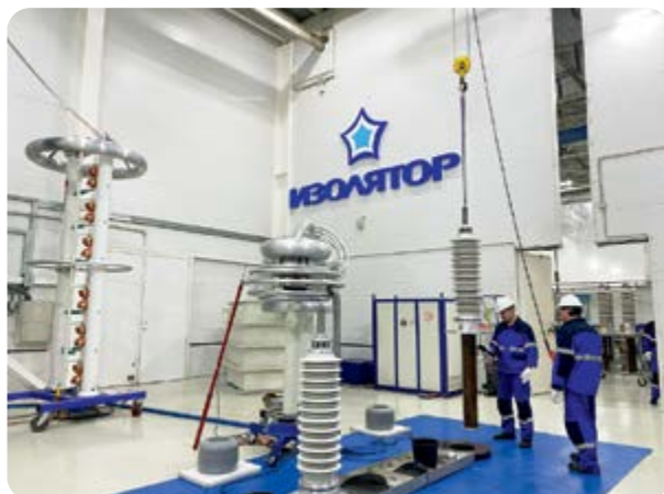
Испытательная станция 10–150 кВ
