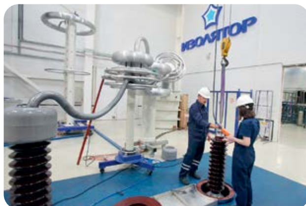
Рис. 29. Электрические испытания вводов 110 кВ
