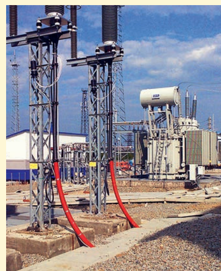
Трансформаторы с высоковольтными вводами «Изолятор» с твердой RIP-изоляцией на подстанции 220 кВ «Могоча» Магистральных электрических сетей Сибири
