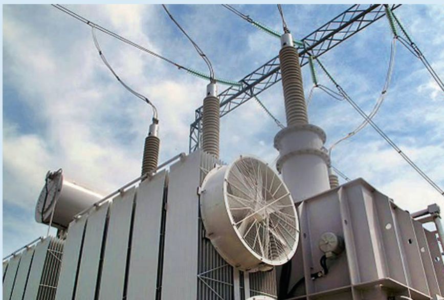
Автотрансформатор мощностью 200 МВА, оснащенный вводами «Изолятор», на подстанции 220 кВ «Северная» в Тульской области (фото: «Россети ФСК ЕЭС»)
