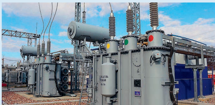
Трансформаторы с высоковольтными вводами «Изолятор» на подстанции 110 кВ «Аянская» в Симферопольском районе (фото: ГУП РК «Крымэнерго»)
