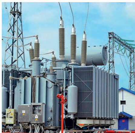
Трансформаторы с вводами «Изолятор» на подстанции 220 кВ МЭС Юга (фото: «Россети ФСК ЕЭС»)
