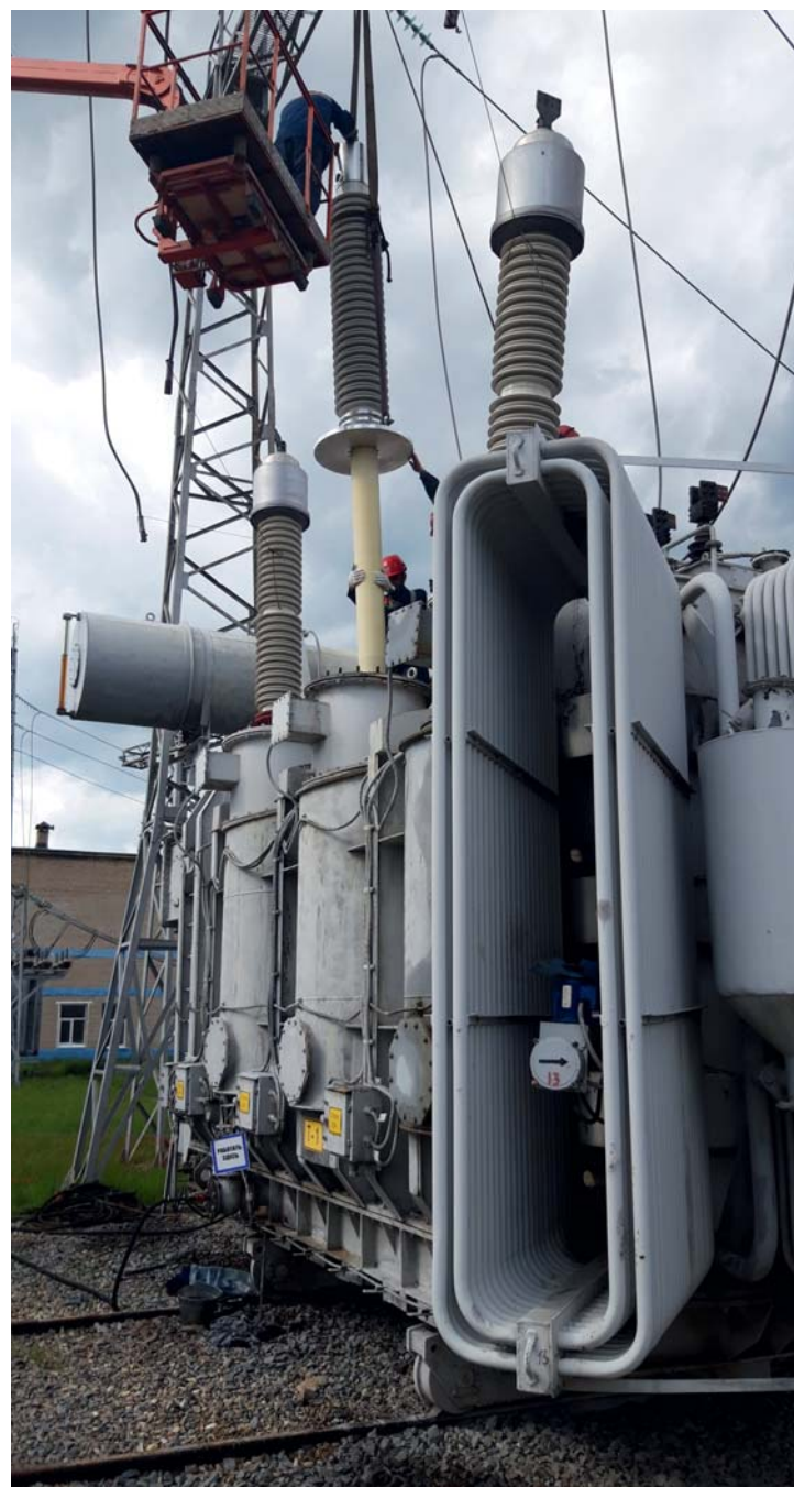
Монтаж ввода 252 кВ с RIN-изоляцией на трансформаторе 40 МВА подстанции 220 кВ «Дальняя» во Владимирской области
