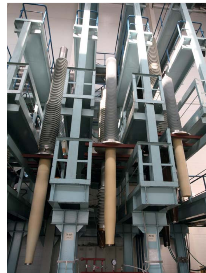
Вводы 500, 330 и 220 кВ с RIN-изоляцией на технологических стойках сборочного цеха завода «Изолятор»
