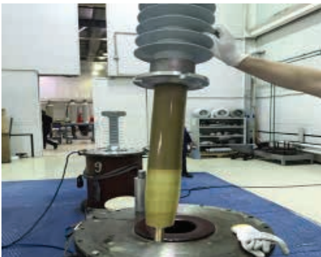
Рис. 10. Ввод 35 кВ в Испытательном центре
