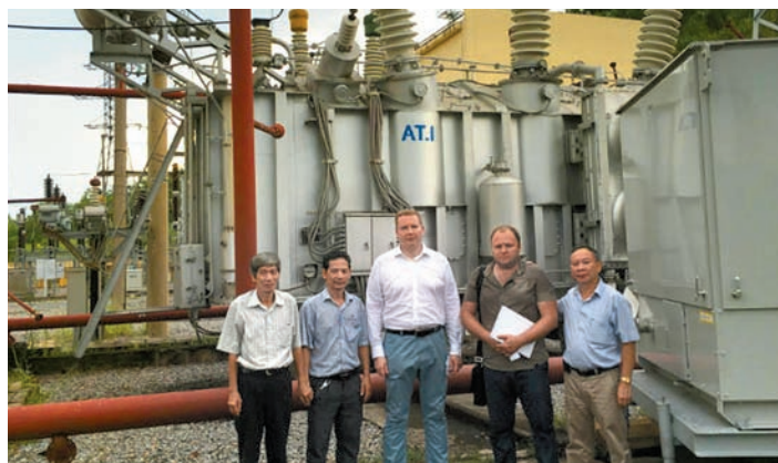
ГЭС Хоабинь. Вводы служат здесь уже более 30 лет, подтверждая высокое качество и долговечность продукции компании «Изолятор»
