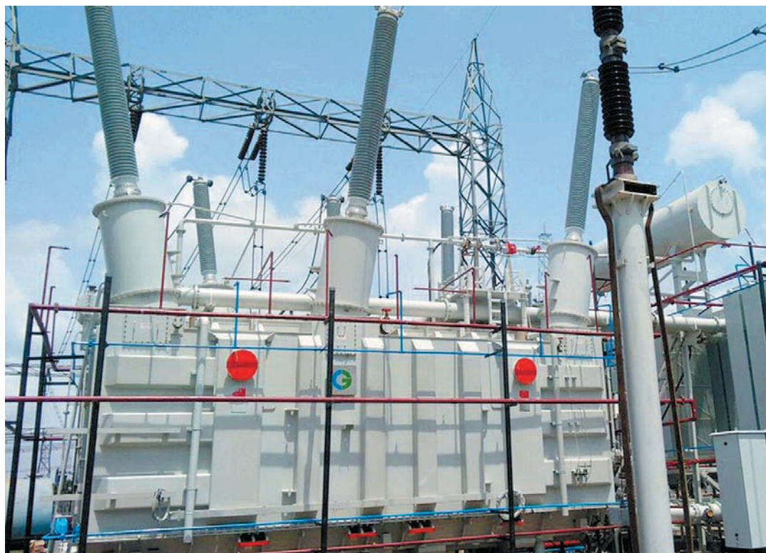
Вводы «Изолятор» на трансформаторе подстанции Vamnauli
