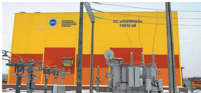
Подстанция «Полянка» в Подмоскowie. Фото с сайта ПАО «МОЭСК»
