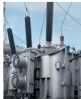
Вводы 220 кВ с RIP-изоляцией, установленные на трансформаторах ГЭС Хоабинь в 2016 году
