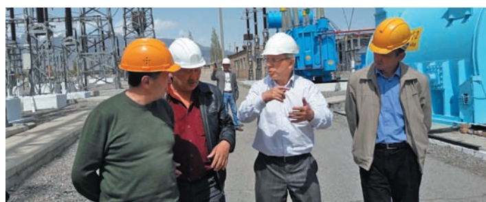
На подстанции Национальной электрической сети Кыргызстана, второй справа — Виктор Кирюхин
