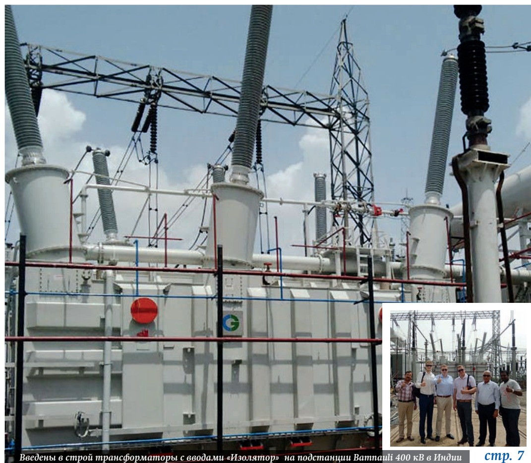
Введены в строй трансформаторы с вводами «Изолятор» на подстанции Ватпалли 400 кВ в Индии
