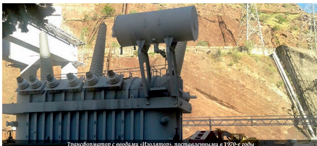
Трансформатор с вводами «Изолятор», поставленными в 1970-е годы
