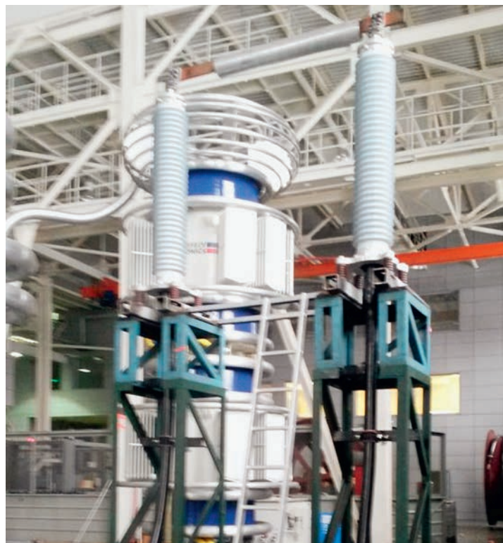
Концевая кабельная арматура в испытательной лаборатории
