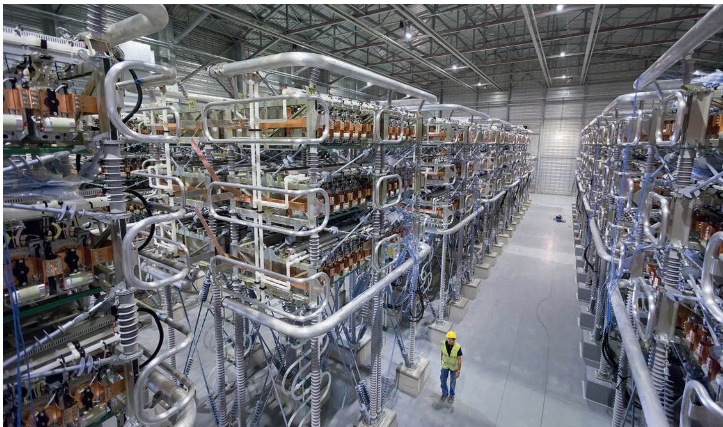
Зал выпрямительного оборудования передачи постоянного тока между Францией и Испанией. Мощность 1000 MWt на основе IGBT
