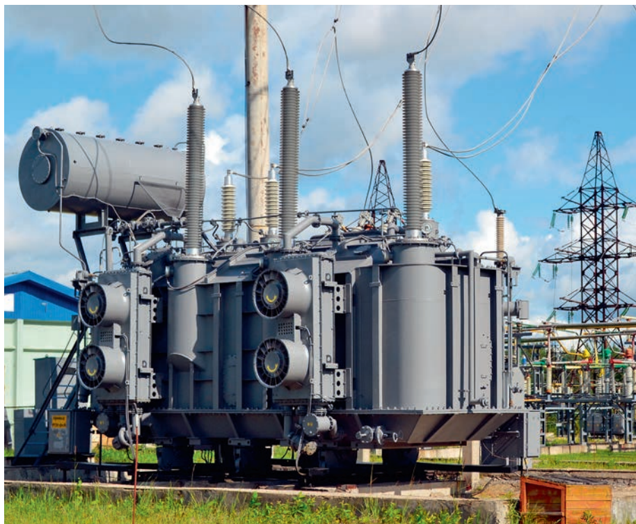
Вводы «Изолятор» классов напряжения 220 и 110 кВ на трансформаторе подстанции ФСК ЕЭС
