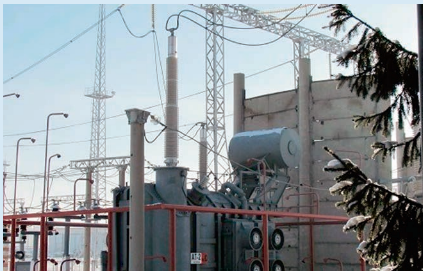
Вводы «Изолятор» классов напряжения 500 и 220 кВ на трансформаторе подстанции ФСК ЕЭС
