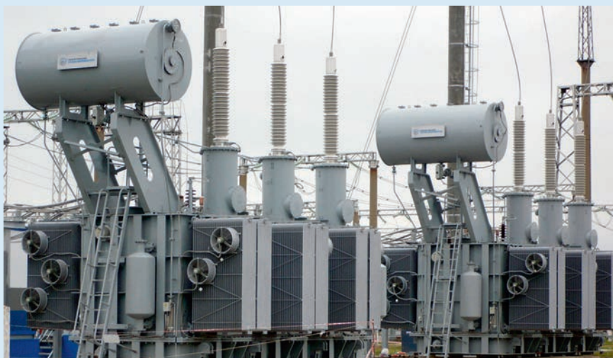
Вводы «Изолятор» 220 кВ на трансформаторах завода «Тольяттинский Трансформатор»
