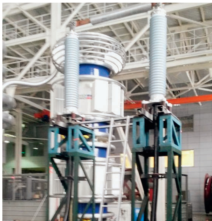
Концевая кабельная арматура в испытательной лаборатории
