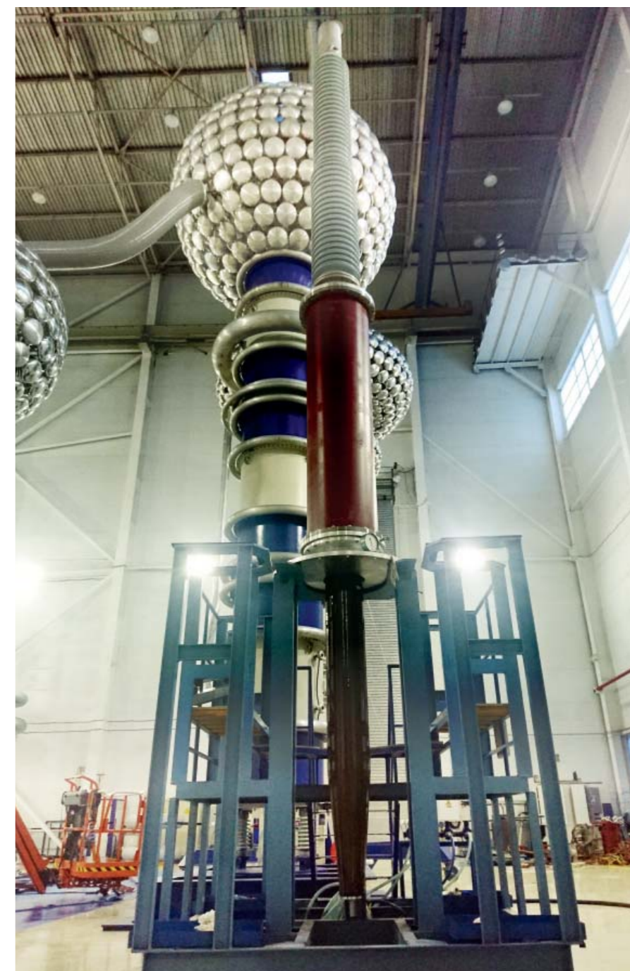
Испытания на заводе «Изолятор» ввода «масло–элегаз» на класс напряжения 500 кВ: сверху установлен технологический ввод 500 кВ, через который прикладывается напряжение; в середине — технологический испытательный бак с элегазом; снизу — испытываемый ввод
